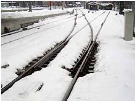
Abbildung 1: Weichenheizung, Quelle: https://de.wikipedia.org/wiki/Weichenheizung
