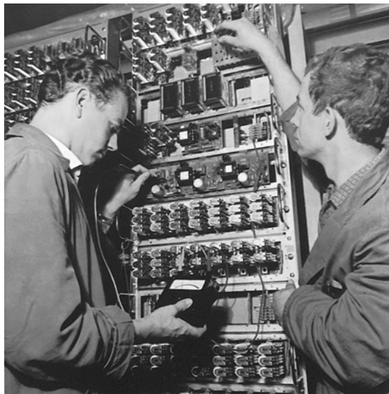
Abbildung 59: Heller-Schaltschrank mit Relaisrahmen 1461
